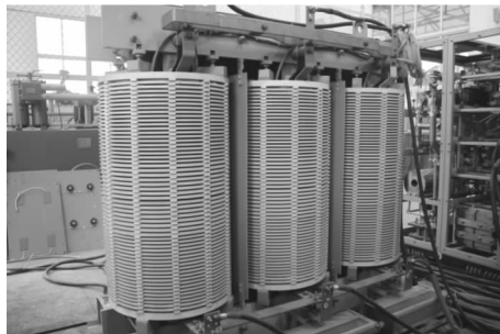
图1 变压器的实际图片
